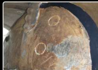
バタフライ弁のゴム部補修
