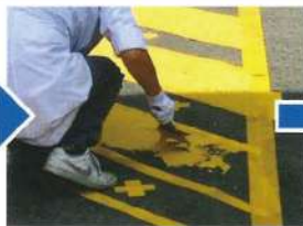
塗布面をゴムベラ等で均一にし、約1~2mm厚程度に塗り広げます。
