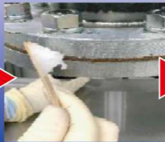
② 漏油箇所に塗布
